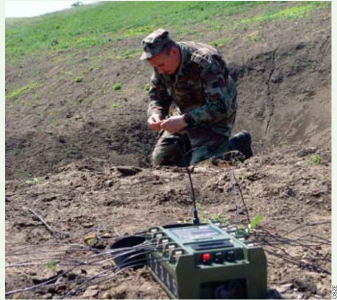
Ein Pionier der moldauischen Armee bereitet ein funkgesteuertes System für die Sprengung von Sprengstoff vor.
