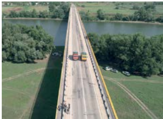
Текущая работа по технической ревизии моста между селами Гура-Бычулуй и Бычок, который является одним из звеньев международного транспортного коридора, связывающего Молдову с портом Одессы и странами Европейского союза. (ОБСЕ)
